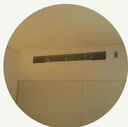
Ar condicionado por condutas
