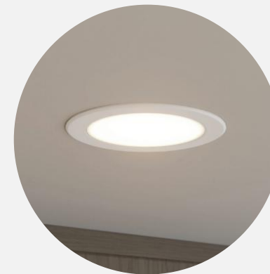
Sistema de iluminação de tetos
